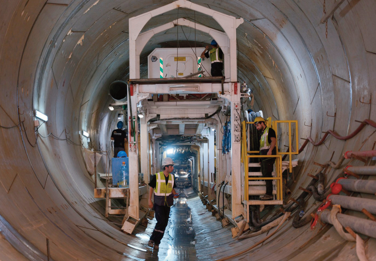
SEGMENT KAPLAMA YAPILIYOR: Yer altı kazılarının planlanan takvim doğrultusunda ilerlediği projede, tünel dayanıklılığını sağlayan segment kaplama imalatları da eş zamanlı olarak gerçekleştiriliyor.
